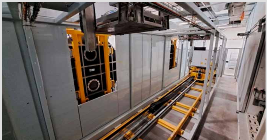
Die neue Zweikammeranlage ist Teil einer umfassenden Neugestaltung der Prozesslandschaft sowie des Reinigungsvorgangs mit automatisiertem Bauteiltransfer zwischen Hochregallager und Montage.
